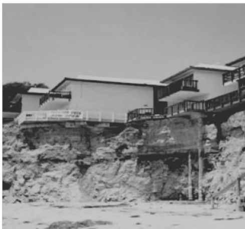
图 1-10 海岸侵蚀造成的破坏
