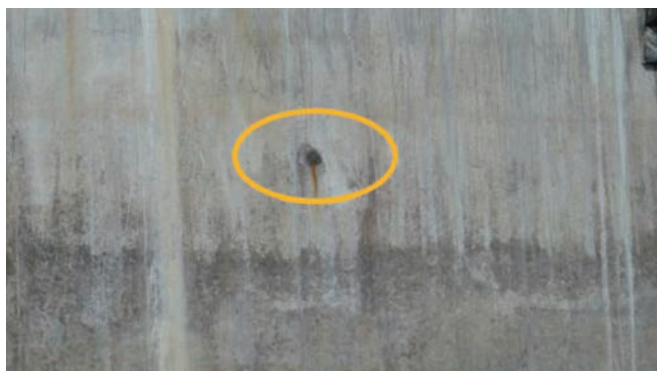
码头胸墙拉杆孔封堵质量差导致锈蚀
