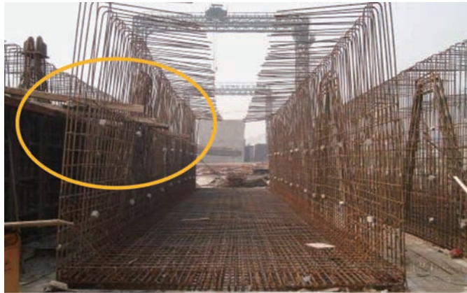
绑扎过程中架立筋设置不足钢筋整体偏位
