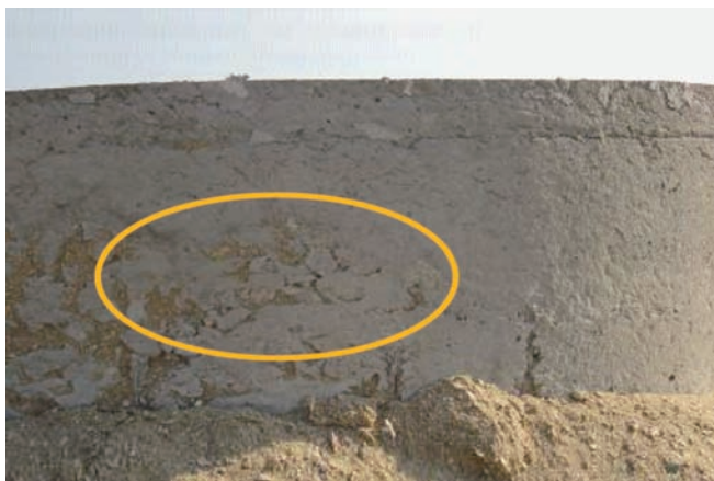
混凝土表面质量缺陷
