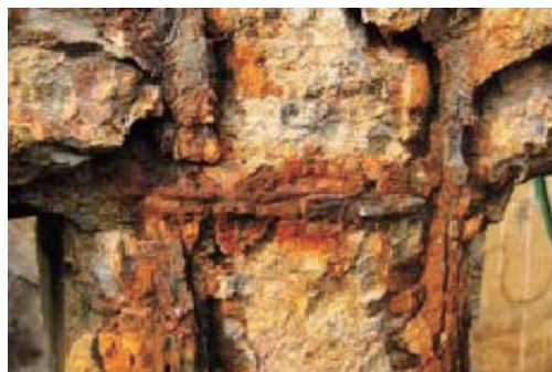
钢筋锈蚀导致混凝土膨胀开裂
