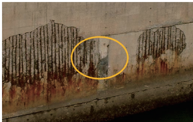
钢筋混凝土构件被碰撞损伤
